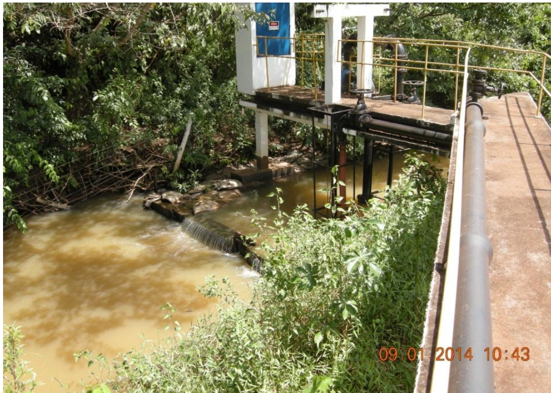
Foto: Rede Captação de Água Bruta
